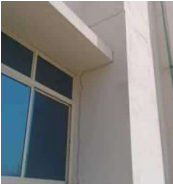
Рис.7: Трещина над окном из-за усадки
