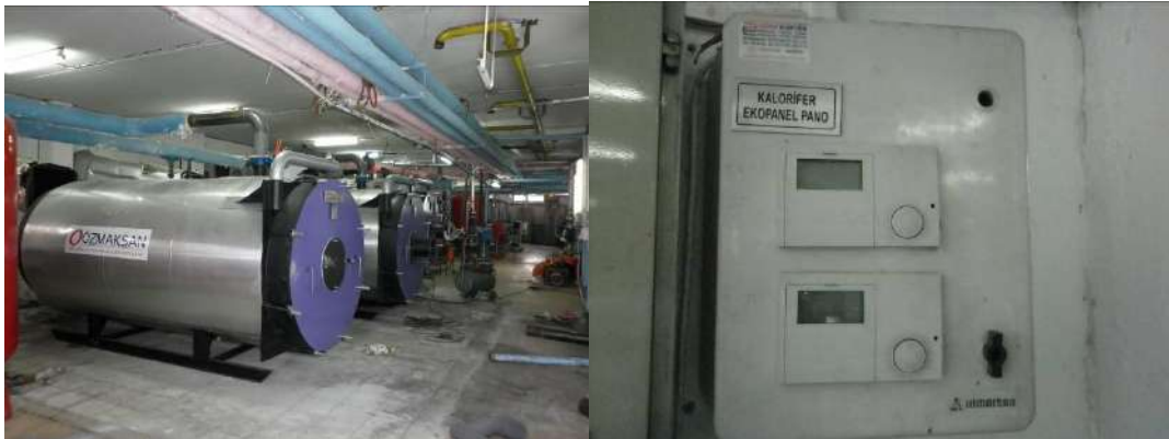
RESİM4.1. Kazanlar ve Ecopanel
