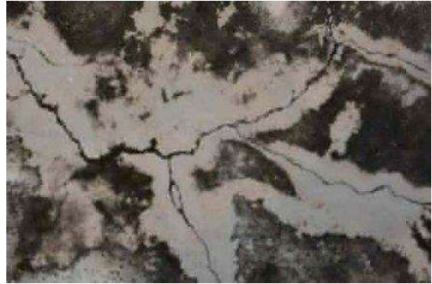
Рис.8: Бетонная трещина из-за движения влаги
