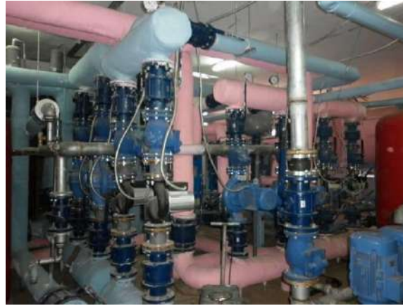
Resim 5.2. Sıcak Su Pompaları
