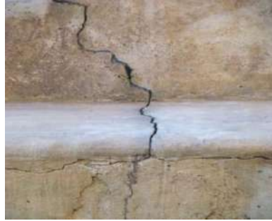
Рис.4: Бетонные строительные трещины из-за движения ползучести
