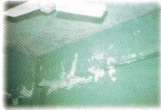
Рис.11: Утечка из кровельной плиты
