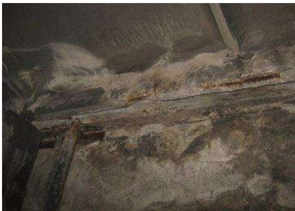
Рис.5: Растрескивание из-за коррозии арматуры
